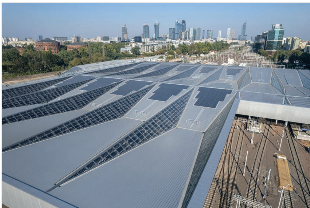
Fot.4. Moduły umieszczone na dachu wyposażyliśmy w funkcję grzewczą, usuwającą oblodzenie i śnieg.
